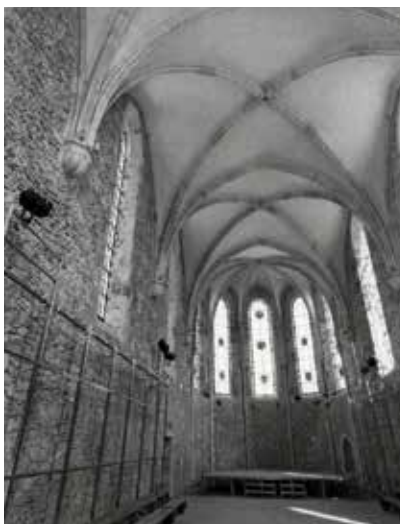
La première restauration de la chapelle (1971-1973) avait laissé les murs nus, sans enduit ni peinture.
